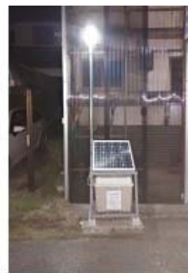
木炭蓄電器を利用した LED 照明
